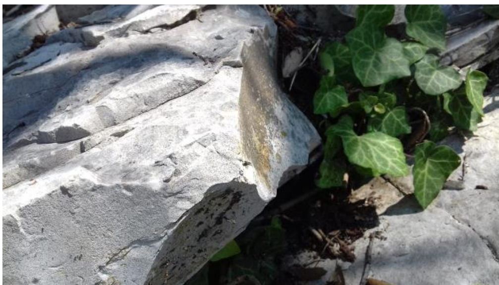
Рис. 7. Следы сколов на каменных плитах на прибрежной территории пансионата «Багрипш» (фото Е.А. Мироновой).
